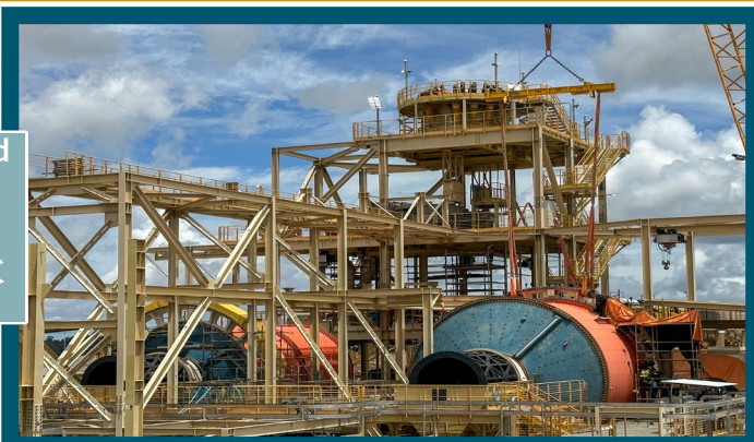
Intensive Leach Reactor 强化浸出反应 器
